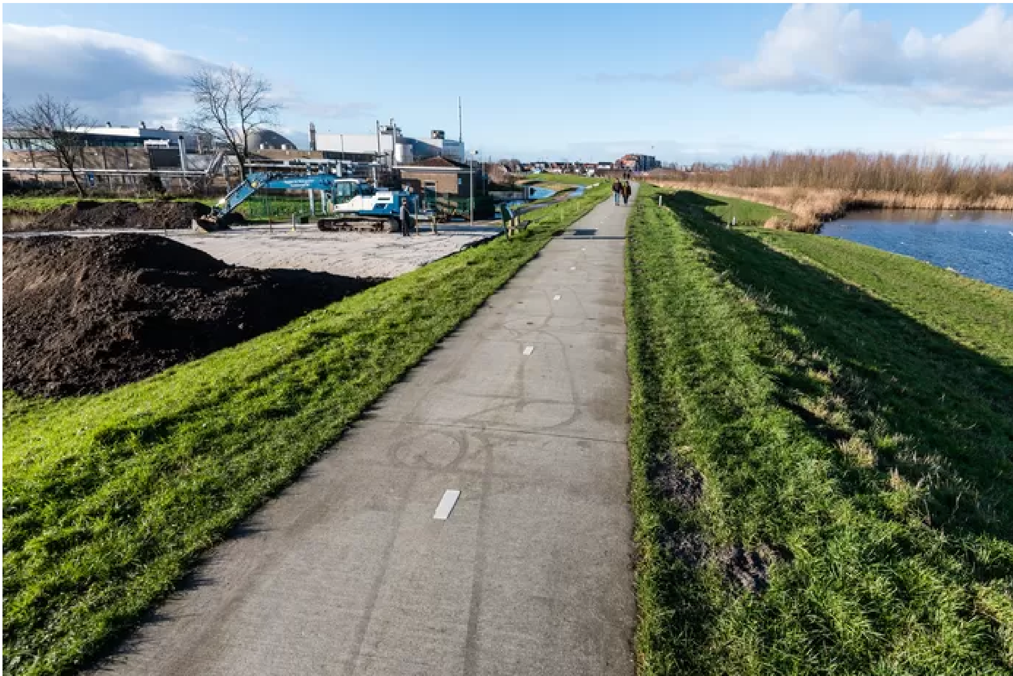
Aan de Oostdijk in Bunschoten zijn de voorbereidende werkzaamheden voor de overtoom begonnen. © Cees Wouda
